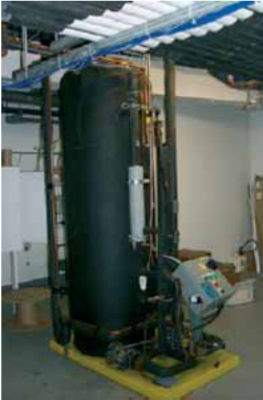
Şekil 5. Orta sıcaklık sıvı pompalama istasyonunun görünüşü.
